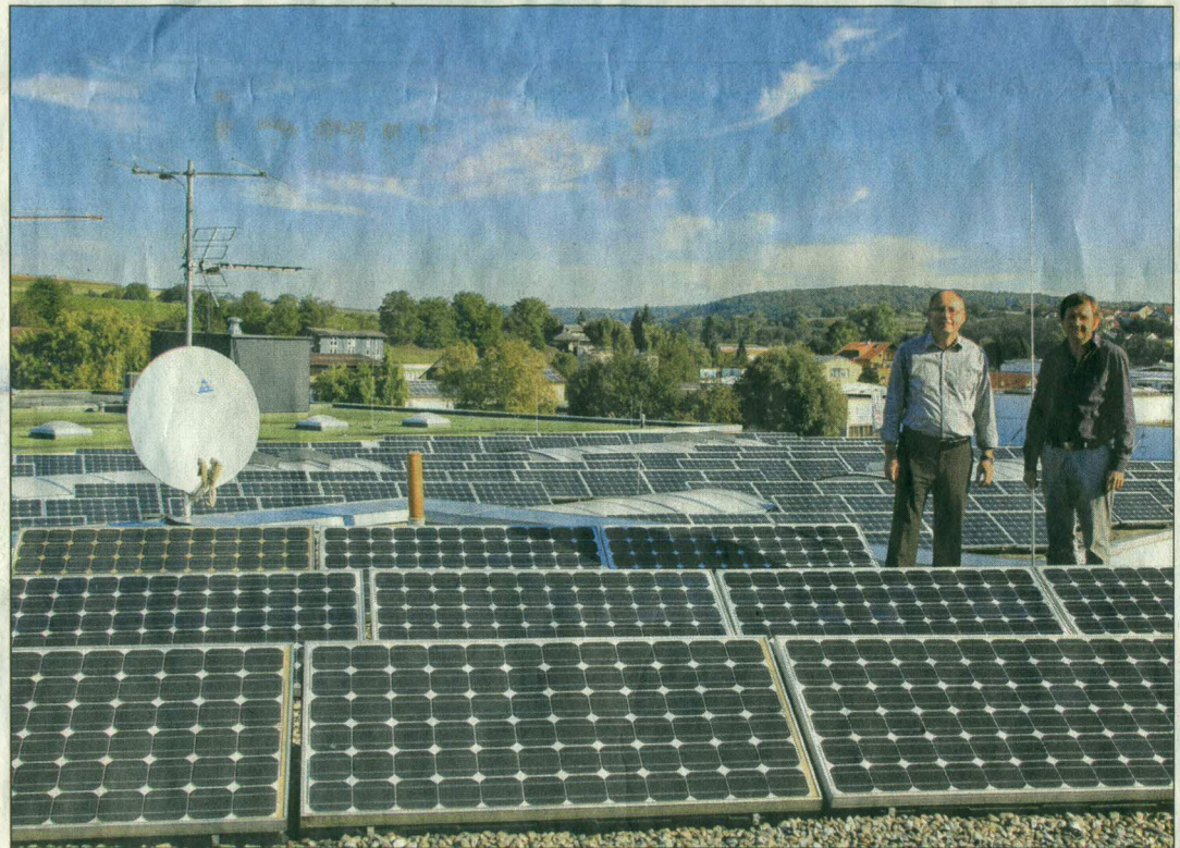
FASZINIERT VON ÖKOLOGIE UND TECHNIK: Firmenchef Günter Vollmer (links) und Frank Morlock auf dem Dach seines Firmengebäudes mit Blick auf die neuen Carports fürs Personal. Foto: Faulhaber
